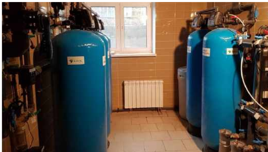
Станция водоочистки в ЖК «Дом мечты»
