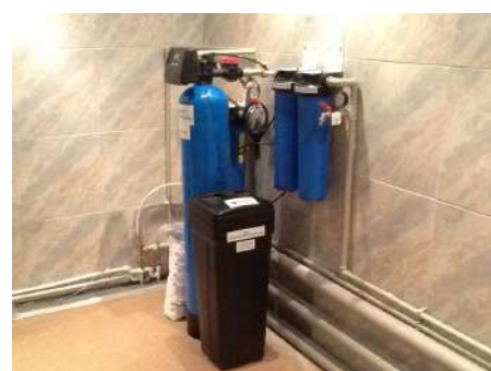
Водоочистка в частном доме
