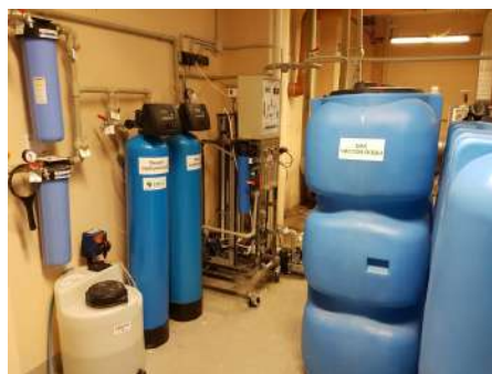
Станция водоочистки на предприятии
