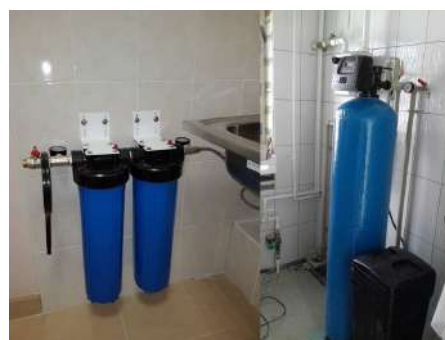
Водоочистка в частном доме
