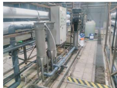
Станция водоочистки на предприятии
